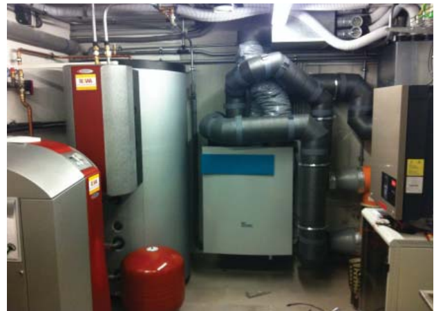
Technikraum mit Wärmepumpe, Komfortlüftung sowie Photovoltaik-Wechselrichter
