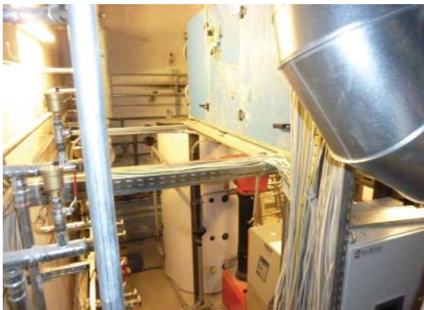
Heizungsanlage bzw. Technikraum
