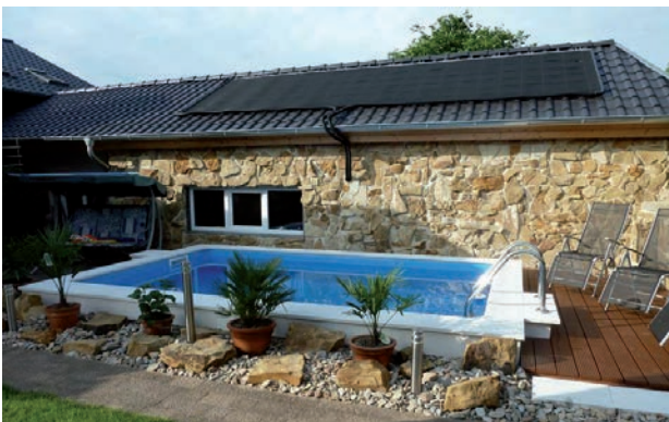
Schwimmbadabsorber (Foto: www.selbstbau.com)
