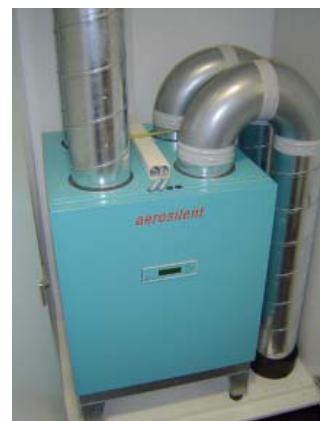
Drexel und Weiss Lüftungsgerät Foto: Röster
