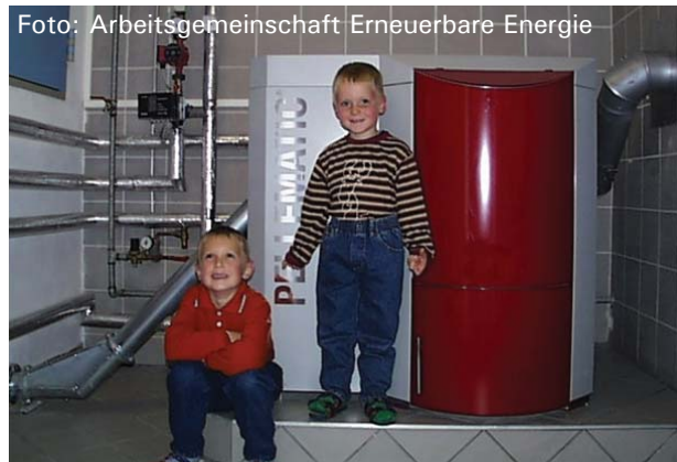
Heizraum mit Pelletskessel (nahezu ein Wohnraum)
