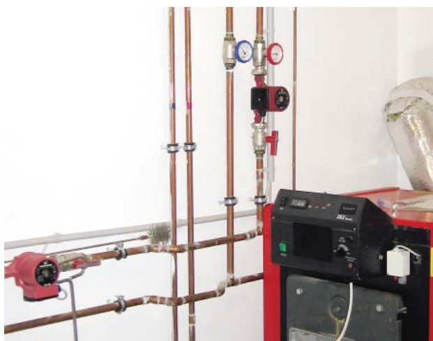
So nicht! Ungedämmte Rohre verschwenden Energie
