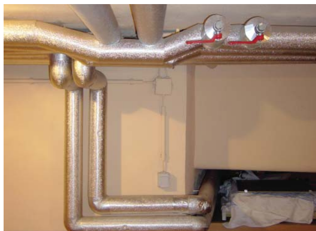
So wird's gemacht: Gedämmte Heizungsrohre bringen die Energie dorthin, wo sie gebraucht wird
