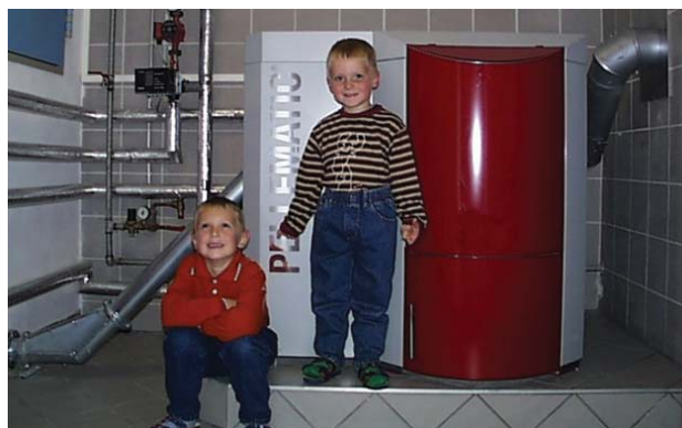
Heizraum: Foto AEE-Villach (Ökofen)
