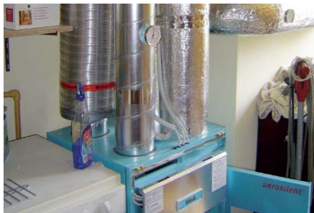
Eine Wohnraum-Komfortlüftung im Altbau garantiert höchsten Wohnkomfort
