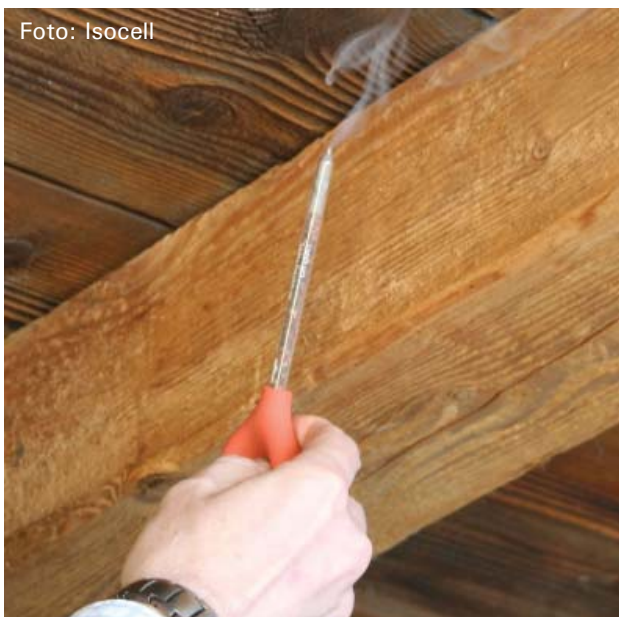
Undichten Stellen auf der Spur
